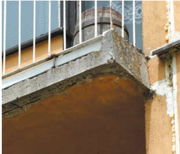
Odspojenie betonu na obrzeżach balkonu.
