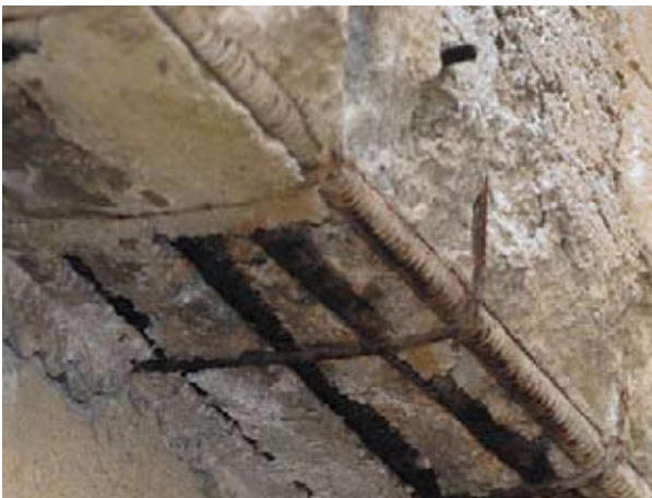
Odspojenie betonu od skorodowanego zbrojenia.
